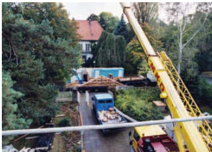
Bild 8 Um möglichst schnell regensicher zu werden, musste es Ruck-zuck gehen, alles steht bereit. Etwas verzögernd wirkten sich die Baustellenschweißungen aus. Die Aufstockungsstruktur (Bild 3) erlaubt drei gut abgegrenzte Bauabschnitte: Nacheinander über den beiden Wohntrakten, zuletzt über dem Treppenhaus.
